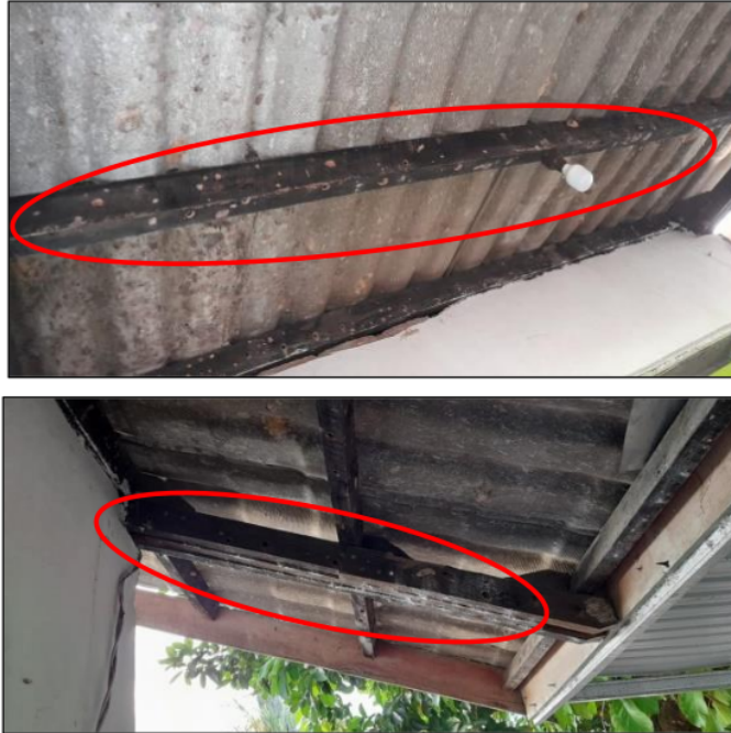
Gambar 4. Serangan Lebah Tukang Kayu Pada Bangunan Kusen
