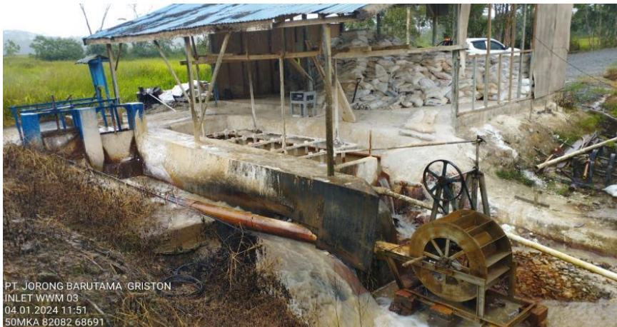
Gambar 3. Fasilitas Pengelolaan Air Limbah di Settling pond WWM 03
