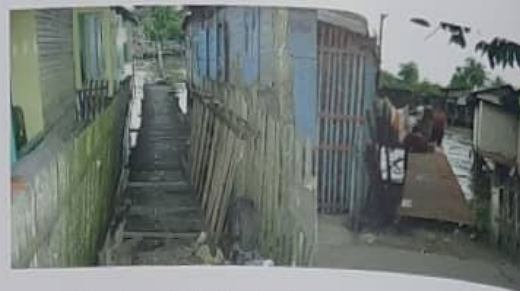
Gambar 10. Titian kayu yang berada di antara bangunan dibuat untuk kepentingan masyarakat yang berada di darat
