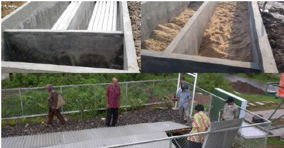
Gambar 12. Instalasi Saringan Pasir (Sumber : Modul Instalasi Saringan Pasir Lambat, 2014)
