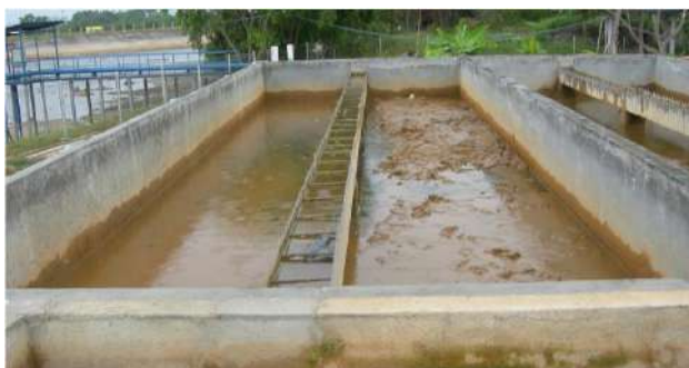
Gambar 14. Bak Pengering Lumpur di SPAM IKK Kota Batam, Kepulauan Riau
