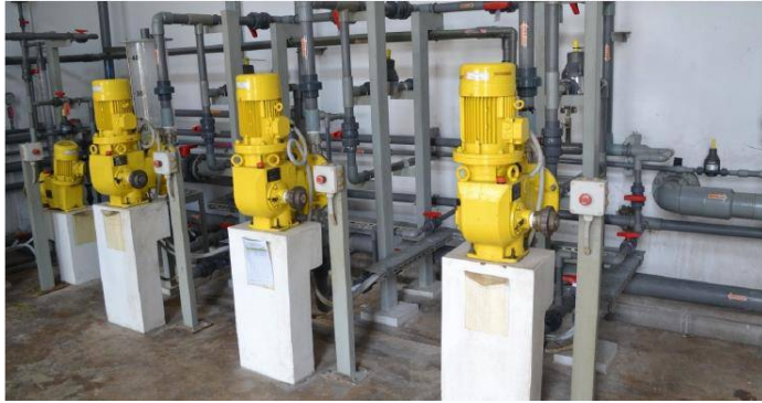
Gambar 56. Pompa dosing pada IPA Kab. Tangerang, Banten
