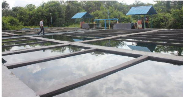
Gambar 54. Filtrasi pada SPAM IKK Kab. Bengkalis, Riau
