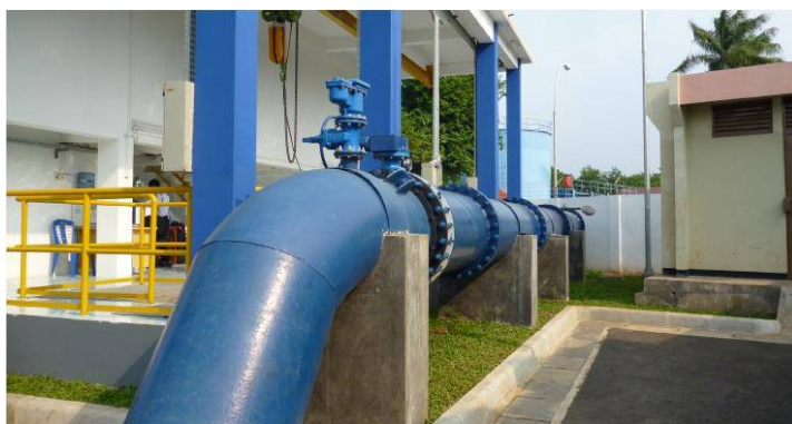
Gambar 48. Air valve pada IPA Kab. Tangerang, Banten
