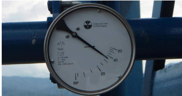
Gambar 63. Flow meter pada SPAM IKK, Kab. Majene, Sulawesi Barat
