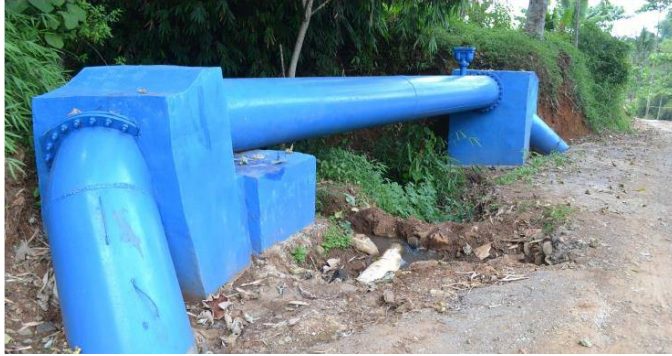
Gambar 61. Perpipaan distribusi pada SPAM Regional Kabupaten Bandung, Jawa Barat
