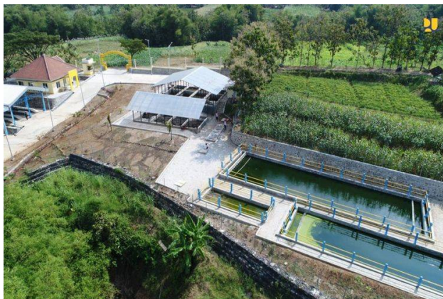
Gambar 27. Instalasi pengolahan limbah tinja
