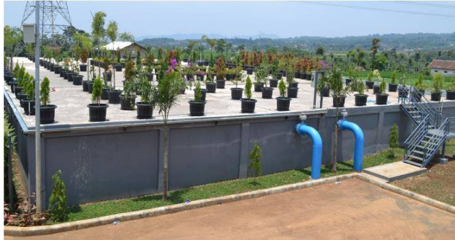
Gambar 58. Reservoir pada SPAM Regional Kab. Bandung, Jawa Barat
