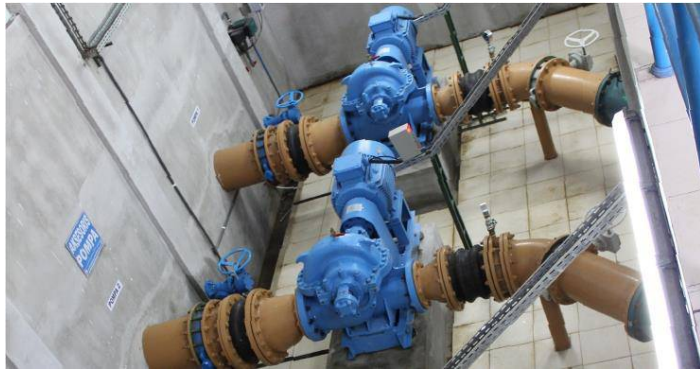
Gambar 47. Pompa pada SPAM Regional Kabupaten Gianyar, Bali
