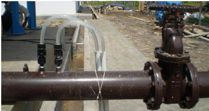
Gambar 57. Injektor bahan kimia pada SPAM IKK Kab. Tulang Bawang, Lampung
