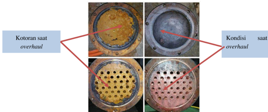
Gambar 7: Foto fouling Pada Saat Komisioning (Overhaul) Sebelumnya
