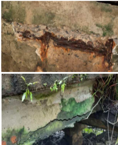
Gambar 10 Bentuk Ekspansi Beton akibat Korosi Tulangan
