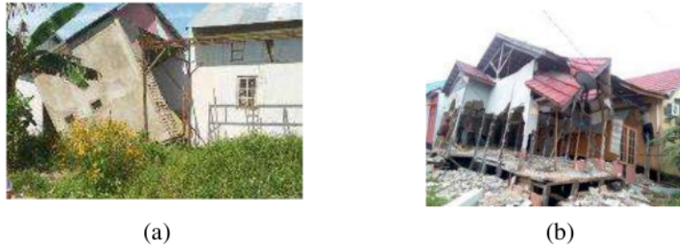
Gambar 8. Kerusakan Bangunan Rumah
