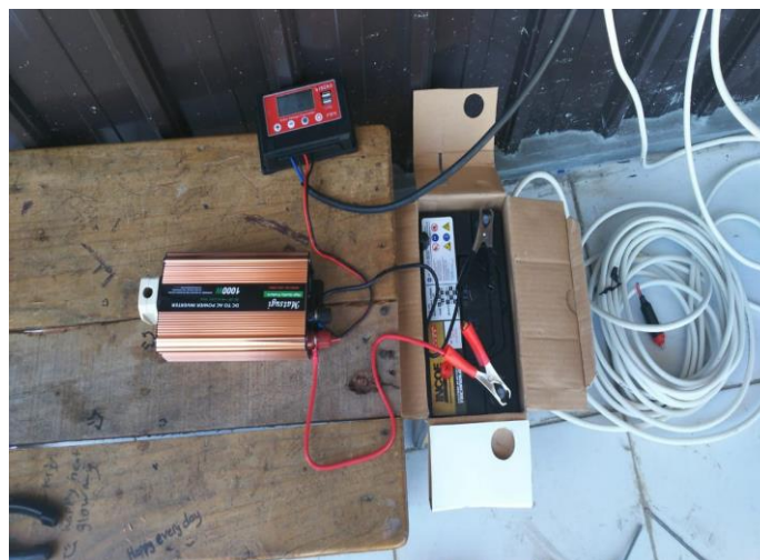
Gambar 7 Koneksi Antara Solar Controller-Baterai-Aki
