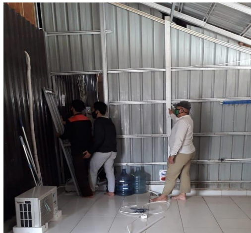
Gambar 5. Kondisi bangunan yang rentan terjadinya hubung singkat
