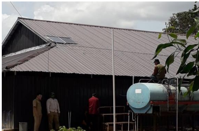
Gambar 6. Hasil Instalasi Teknologi Pendingin Air Pada Sel Surya
