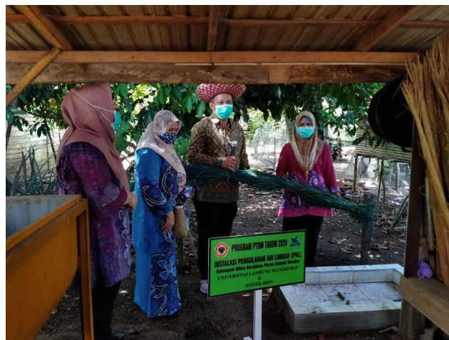
Gambar 3. Instalasi Pengolahan Air Limbah (IPAL)
