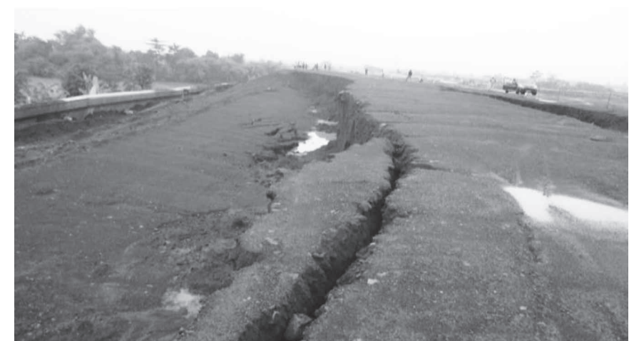
Gambar 8.3. Kelongsoran Badan Jalan Pada Area Ainnya (Mochtar, 2014).
