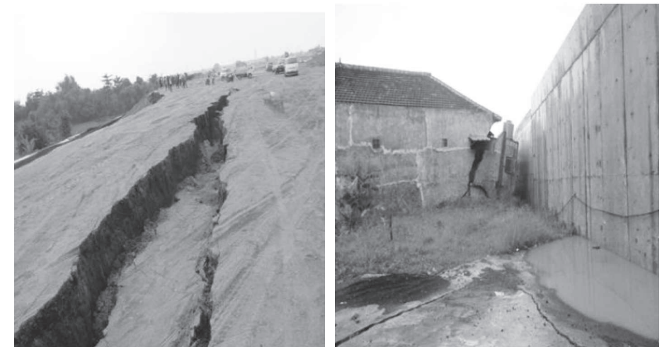
Gambar 8.2. Kelongsoran Badan Jalan dan Dampak Kelongsoran terhadap Rumah di Dekat Area Kelongsoran (Mochtar, 2014).
