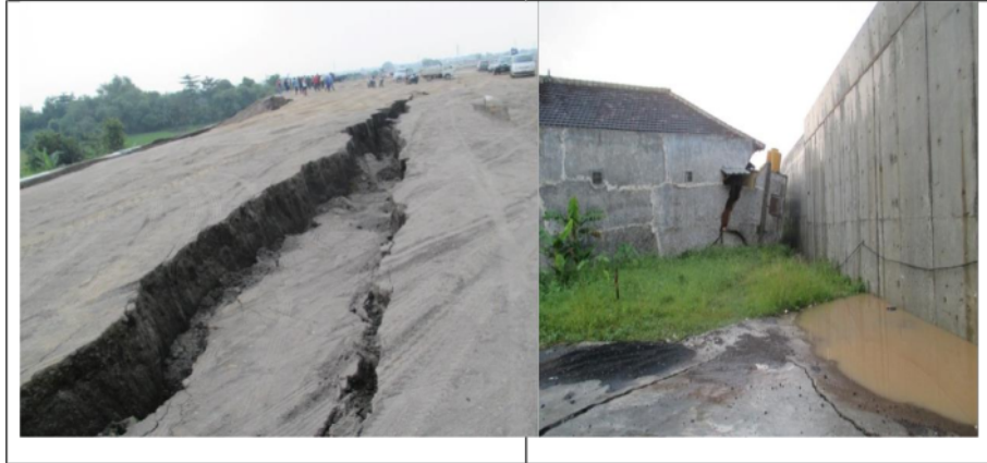
Gambar 9. Kelongsoran badan jalan dan dampak kelongsoran terhadap rumah di dekat area kelongsoran. (Mochtar, 2014)
