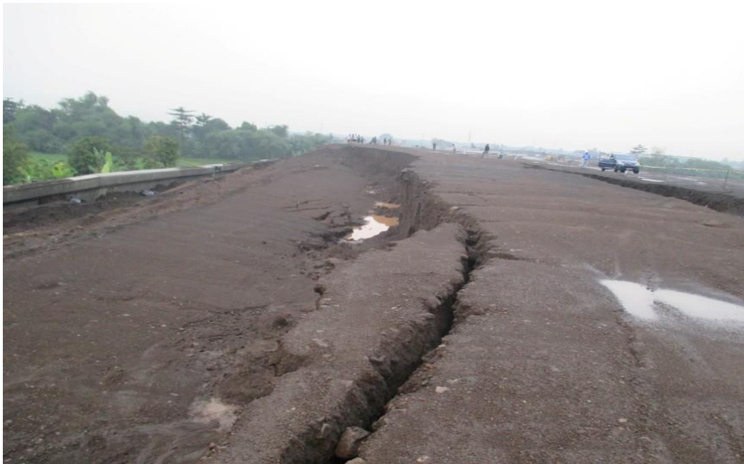
Gambar 10. Kelongsoran badan jalan pada area lainnya. (Mochtar, 2014)
