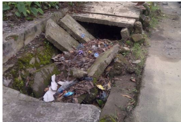
Gambar 4. Jaringan drainase yang sudah rusak tanggal 21 Februari 2014 Lokasi: A. Yani km 34
