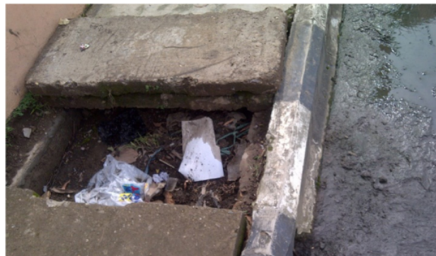
Gambar 3. Saluran drainase yang dimensinya berkurang karena sampah Tanggal 21 Februari 2014, lokasi: Jl. A. Yani Km 36
