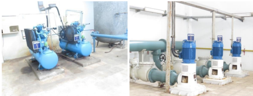
Gambar 2. Pompa Blower dan Pompa Backwash IPA 2 Pramuka PDAM Bandarmasih
