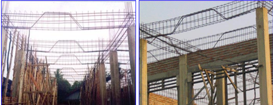
Gambar 1. Pemasangan tulangan tarik balok yang terbalik pada lantai 1 dan 2
