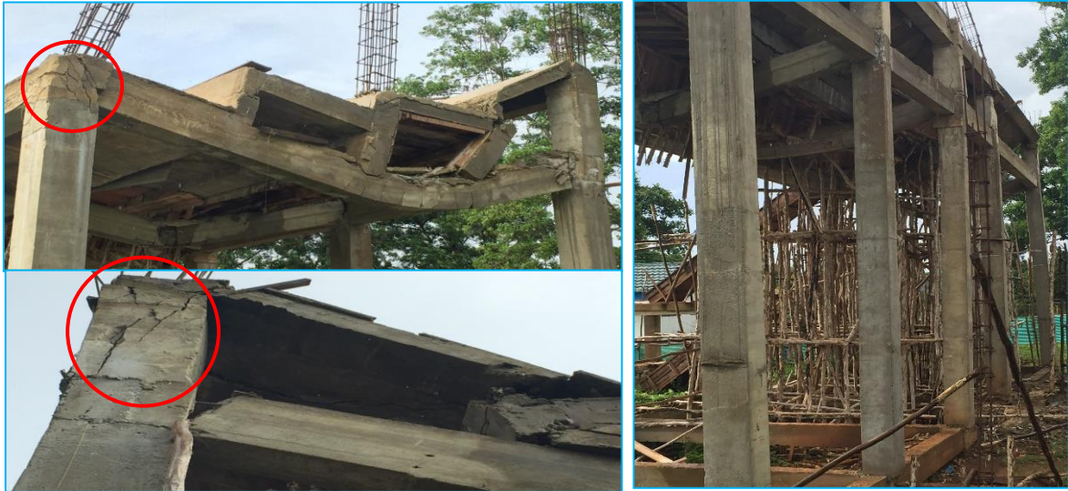
Gambar 4. a. Struktur Kolom Beton bagian atas retak dan remuk, b. Struktur Kolom Beton bagian tengah dan bawah masih baik tidak mengalami retak
