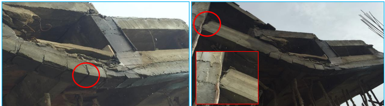
Gambar 2. a. Selimut beton balok beton lantai 1 tidak ada, b. Jumlah tumpuan balok bagian atas terlihat hanya 2 bh.
