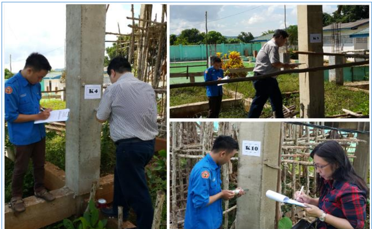
Gambar 3. Pengujian keseragaman mutu beton dengan alat Hammer Test terhadap keseluruhan kolom (10 bh.)
