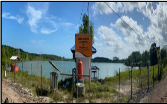
Gambar 5. Fasilitas Air Bersih bagi Desa Mekarjaya dan Desa Banjarsari, salah satu program CSR PT. Borneo Indobara (Desa Ring I)
