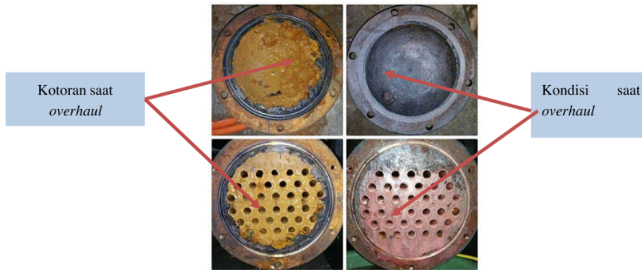
Gambar 7: Foto fouling Pada Saat Komisioning (Overhaul) Sebelumnya
