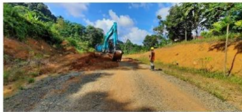
Gambar 2. Kerusakan Badan Jalan Akibat Heaving
