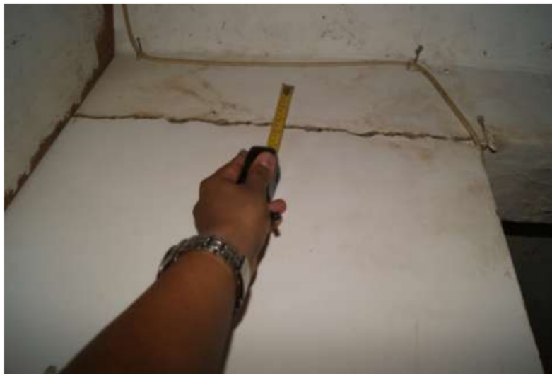
Gambar 3. Retak settlement di lantai dasar sisi kiri sebesar 5 mm
