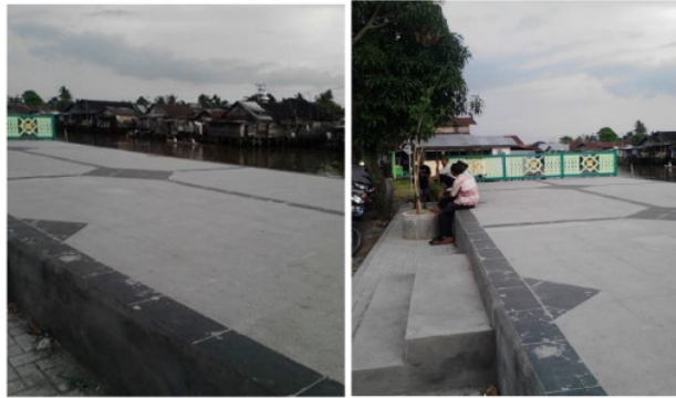
Gambar 5. Penataan Bantaran Sungai Kuin (depan Makam Sultan Suriayah) (Sumber: Expose Dinas PUPR, 2016; Dokumentasi Penelitian, 2021)
