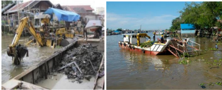
Gambar 2. Pengerukan dan Pembersihan Sungai dalam Perkotaan menggunakan Kapal Biyoko dan Kapal Sapu-Sapu (Sumber: Dokumentasi Bidang Sungai DPUPR Kota Banjarmasin, 2019)
