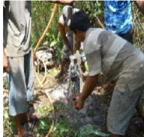
Gambar 22. Ditemukan Material Pasir
